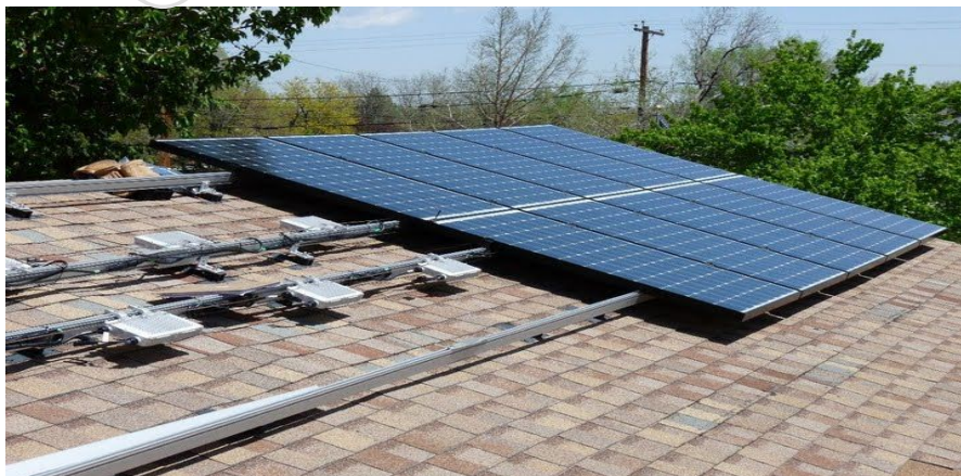
图1 光伏方阵依附于建筑物上
